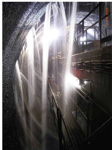
Αιφνίδια εισροή νερού σε σήραγγα TBM (Ισλανδία)
