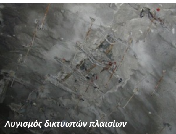
Θραύση του εκτ. σκυροδέματος
