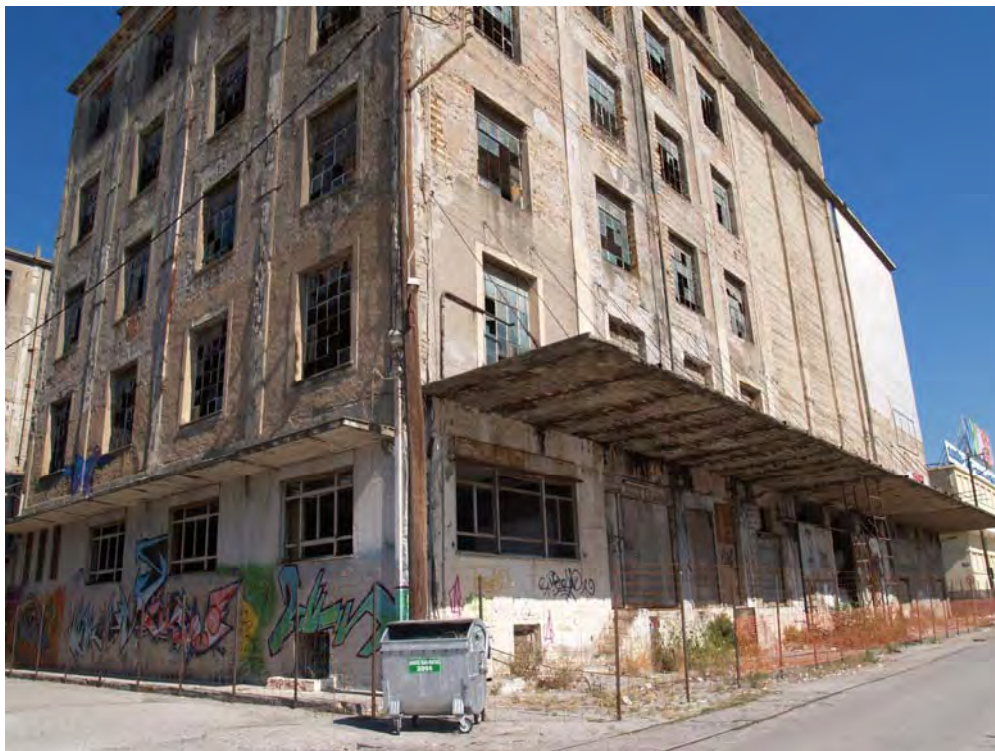
Η πλάγια όψη της Ευαγγελίστριας δείχνει φανερά τα σημάδια της εγκατάλειψης
