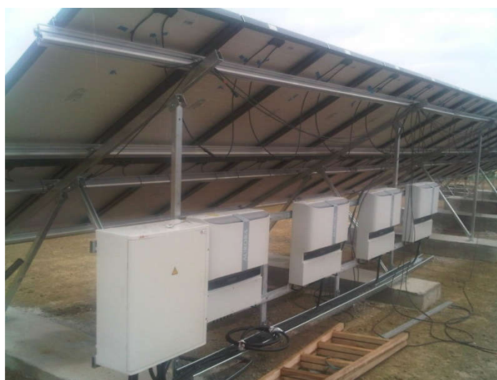
Σύνδεση ηλεκτρολογικού εξοπλισμού
