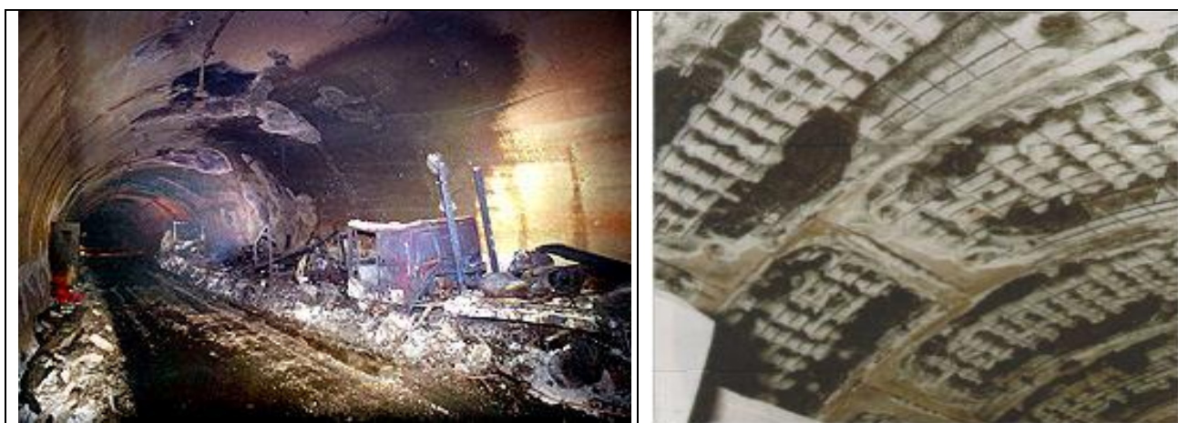
Εικόνα 12.3: Εικόνες από την καταστροφή της σήραγγας της Μάγχης (1996)
