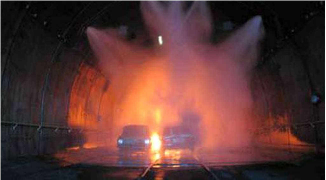
Εικόνα 12.12: Συστήματα ψεκασμού νερού
