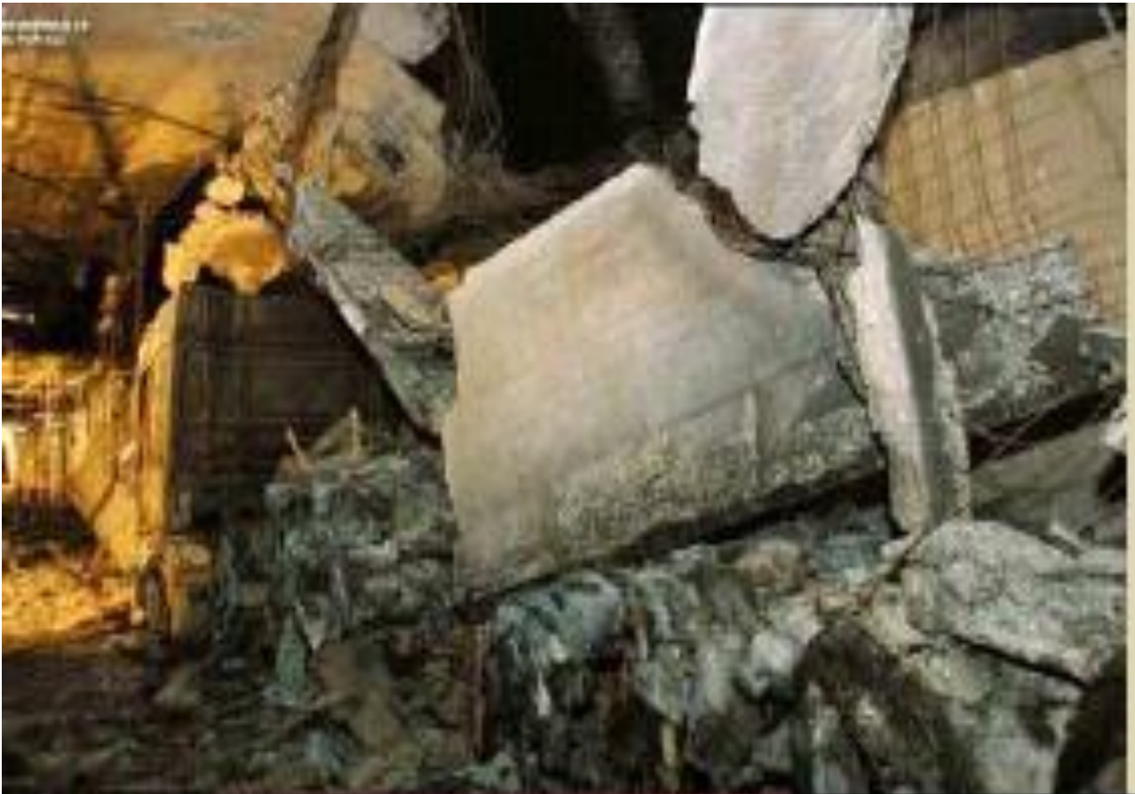
Εικόνα 12.4: Εικόνες καταστροφής της επένδυσης της σήραγγας
