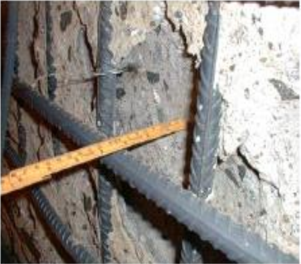
Εικόνα 12.8: Εικόνα αποφλοΐωσης σκυροδέματος μετά από πυρκαγιά
