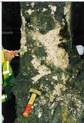
Υποστόλωμα μετά την επίδραση θειικών
