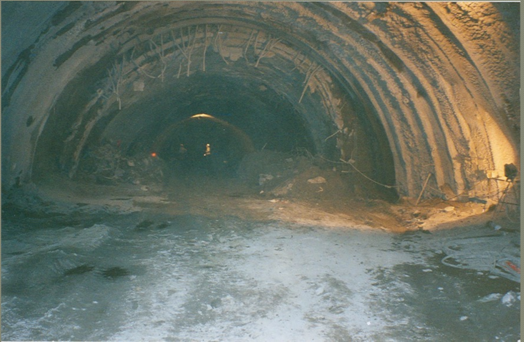
Σήραγγα. Τυμφρηστού. Φαινόμενα σύνθλιψης στον φλύσχη: σύγκλιση οροφής σε σήραγγα σε περιβάλλον ασθενούς διατμημένου φλύσχη
