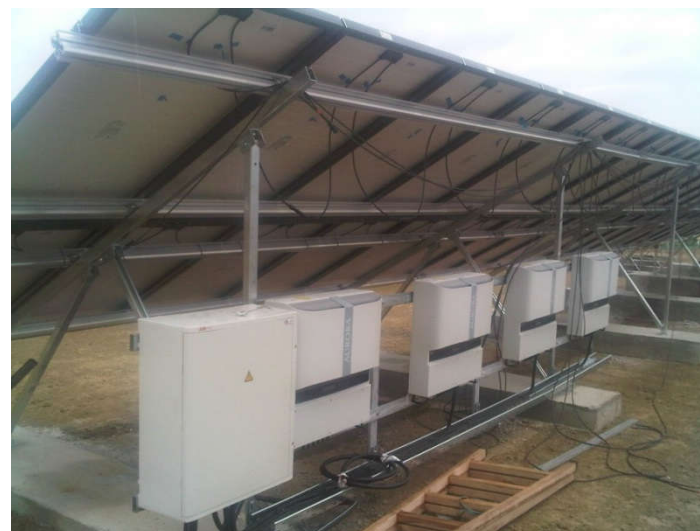
Σύνδεση ηλεκτρολογικού εξοπλισμού
