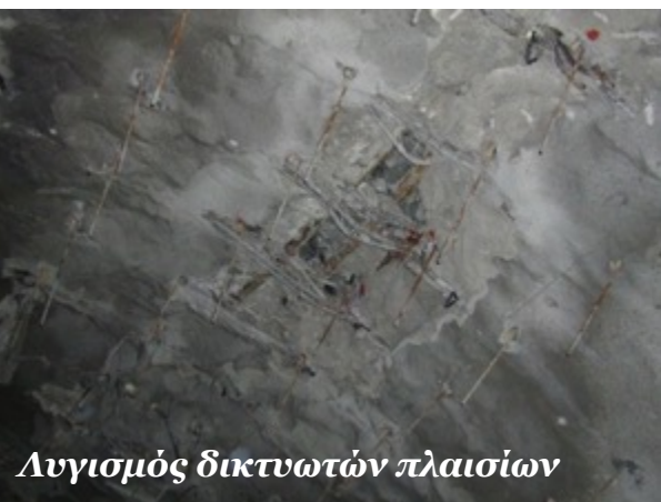
Θραύση του εκτ. σκυροδέματος
