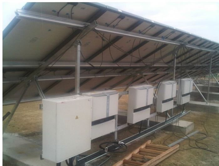
Σύνδεση ηλεκτρολογικού εξοπλισμού
