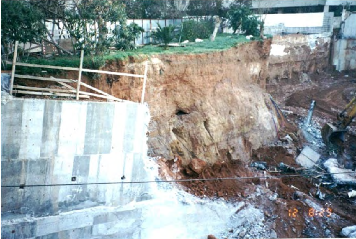
Αστοχία (κατάρρευση) τοίχου αντιστήριξης
