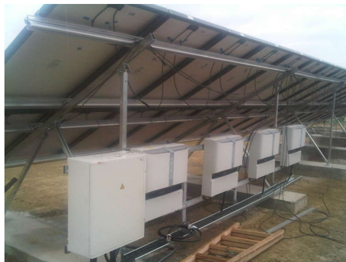
Σύνδεση ηλεκτρολογικού εξοπλισμού
